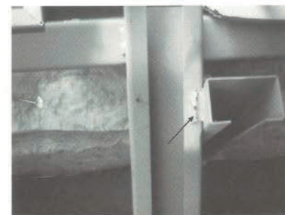
写真 5.2-20 錆止め塗料の溶接焼け
